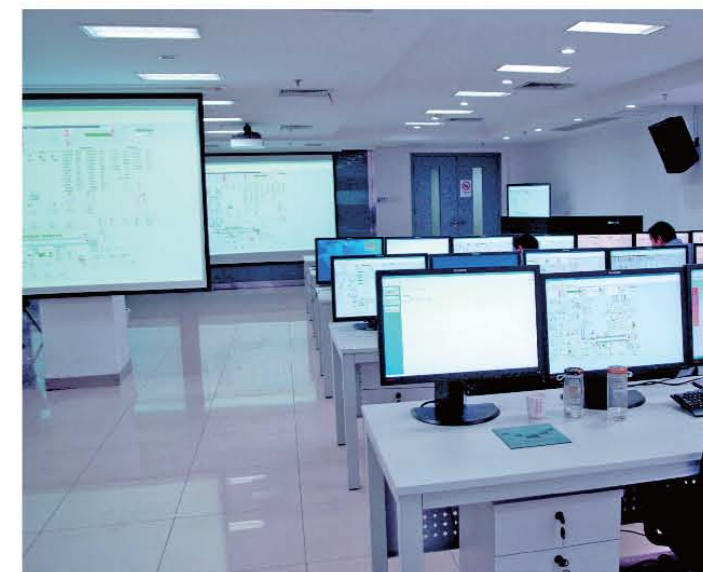
华新水泥能源管理中心监控调度室 Huaxin cement energy management center
